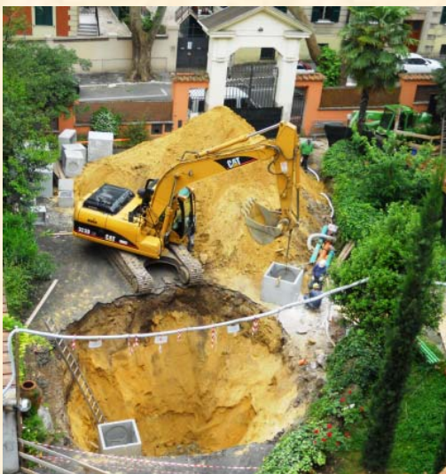
Cortil de acceso a la Facultad, excavación para las descargas del desagüe y aguas pluviales (mayo de 2014)
